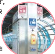
列車非常停止ボタン
