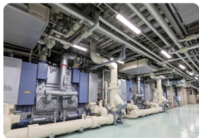
熱供給プラントの一部
