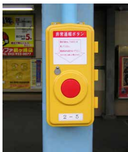
ホームに非常通報ボタンを 設置 (2002年~)
