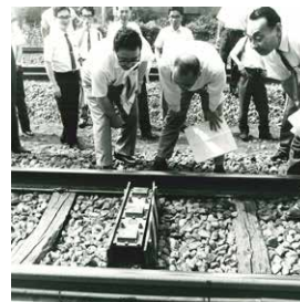
ATS（自動列車停止装置）の設置（1968年～）
